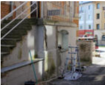
Abb. 11: Putzablösungen und organischer Bewuchs
