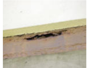
▲ Abb. 6: Zustand der Eisenträger
